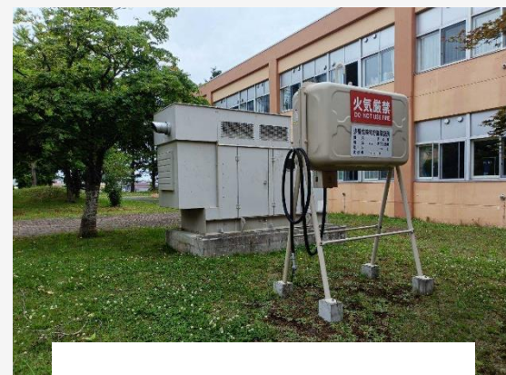
自家発電&軽油タンク
