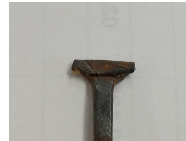
写真4 既存釘(壁)の頭状況
