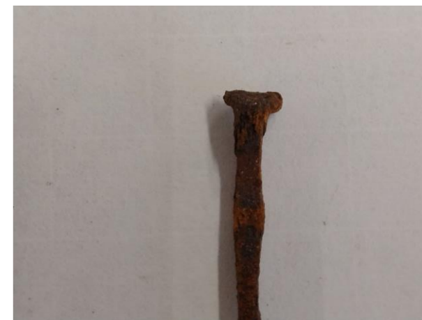
写真2 既存釘(天井)の頭状況
