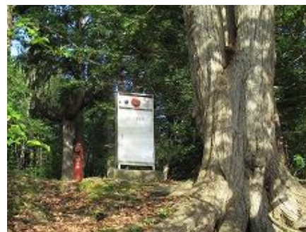
【写真 4-2 既存屋外消火栓】
