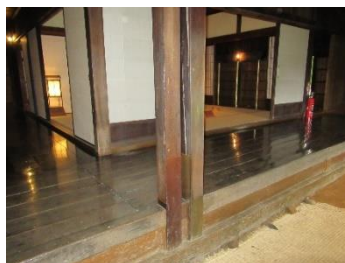
写真 5-7-2 改築による2本の柱
