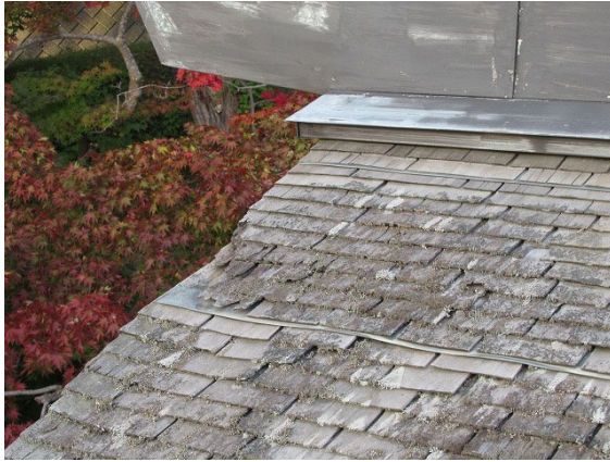
写真3 屋根面劣化状況
