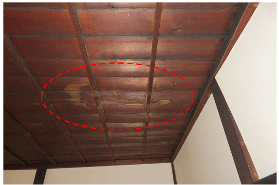
写真8 漏水状況（天井漏水跡）
