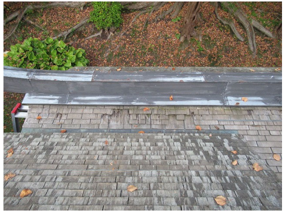
写真6 屋根面劣化状況
