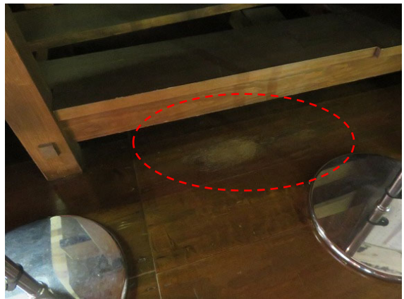
写真10 漏水状況（床面漏水跡）
