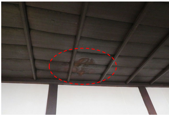
写真7 漏水状況（天井漏水跡）
