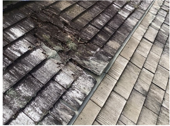
写真4 屋根面劣化状況
