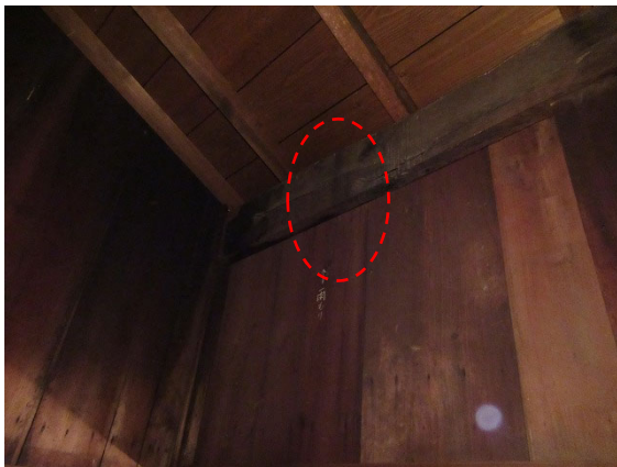
写真9 漏水状況（梁・壁面漏水跡）
