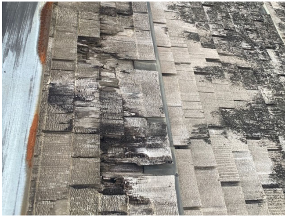
写真5 屋根面劣化状況
