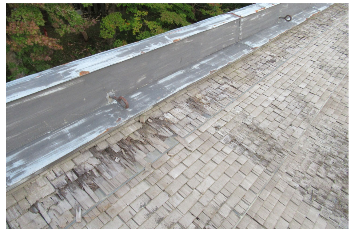
写真4 旧島松駅通所 屋根劣化部分
