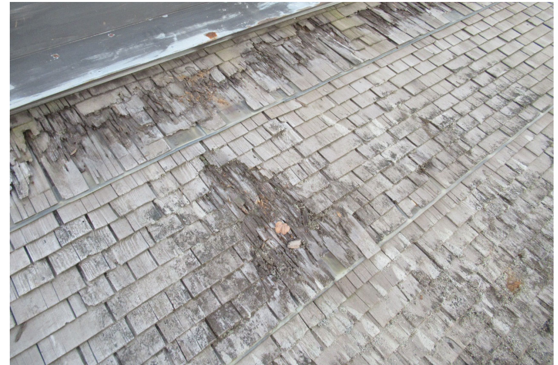
写真3 旧島松駅通所 屋根劣化部分
