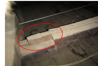
写真2-6 梁継手のゆるみ状況
