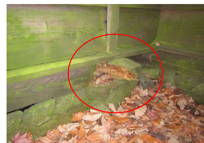
写真2-2 水切り腐朽状況
