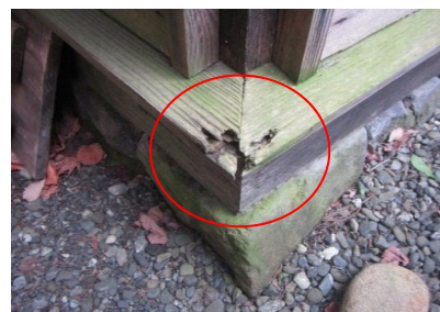
写真2-1 土台腐朽状況
