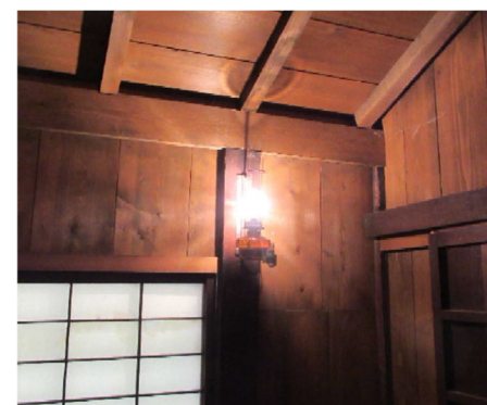
写真3-1 屋内電灯設備
