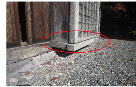
写真2-4 戸袋の劣化状況
