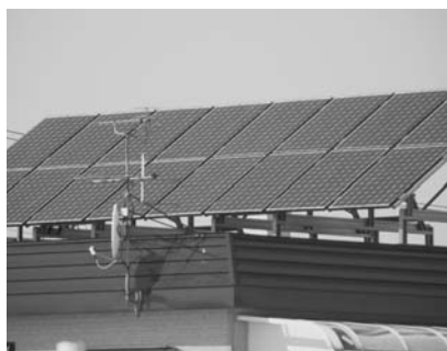
太陽光発電システム
