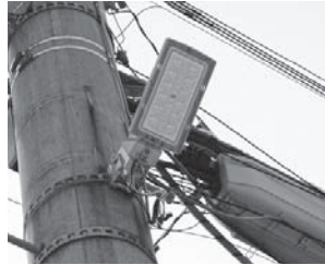
LED化した街路灯
