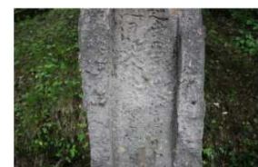
軟石劣化状況
