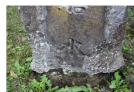
軟石劣化状況
