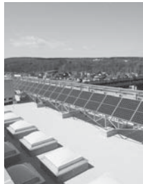
屋上太陽光発電パネル
