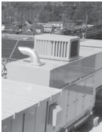
屋上非常用発電機
