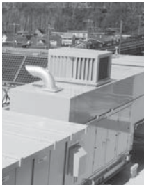
屋上非常用発電機
