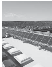
屋上太陽光発電パネル
