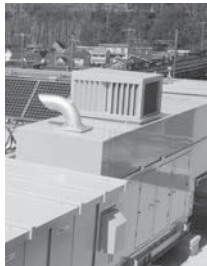
屋上非常用発電機
