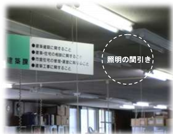
一般的なオフィスの場合、電力消費量の約3割を照明が占めるといわれています。
