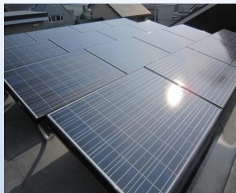
一般家庭用太陽光発電システム
