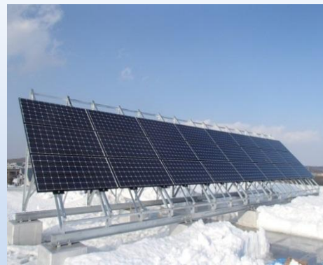
西部中学校の太陽光発電システム 単結晶太陽電池モジュール（215W）48枚を設置
