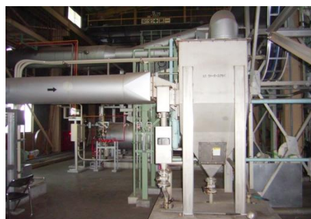
乾燥機排ガスの脱臭・集塵するウォータースクラパー
