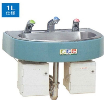
厨房室内手洗器
