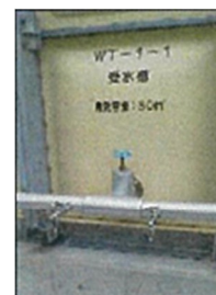
水栓が設置された受水槽
