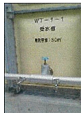
水栓が設置された受水槽
